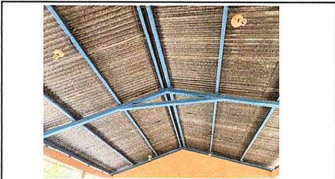
Foto 3: Cubierta de lamina requiere sustitucion
