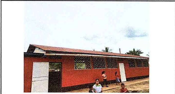
Foto 1: Cubierta de lamina en mal estado
